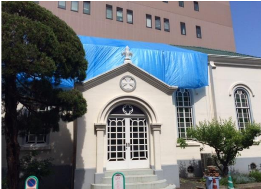
【剥がれ落ちた屋根】
